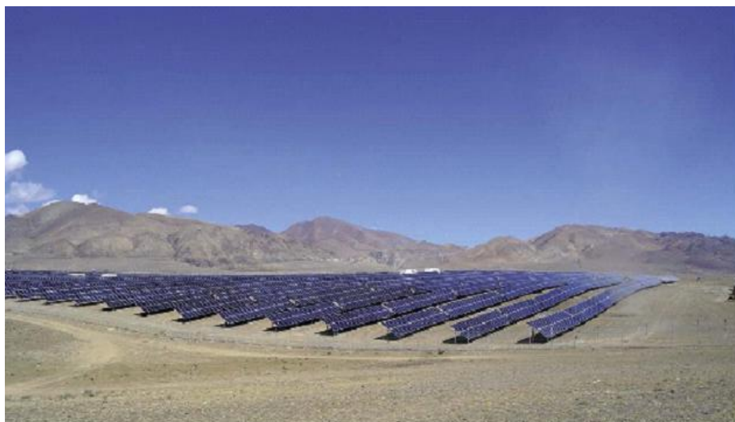
Рис. 19. Сетевая солнечная электростанция, 5 МВт, Республика Алтай
