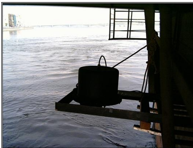
Рис.6. Малогабаритный светодиодный регистратор нефтепродуктов «Краб», установленный на Литейном мосту через р. Неву
